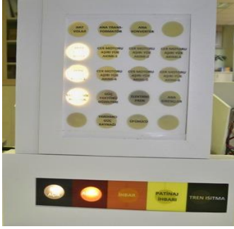
Şekil 13: Elektronik şalter arızasında lamba durumları
