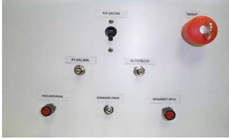
Şekil 14: Elektronik şalter arızasında şalter durumu
